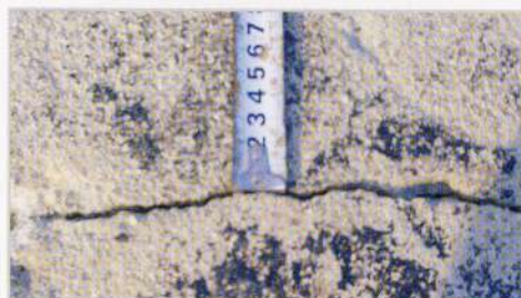
▲ 균열부위 상태 및 균열폭 조사
